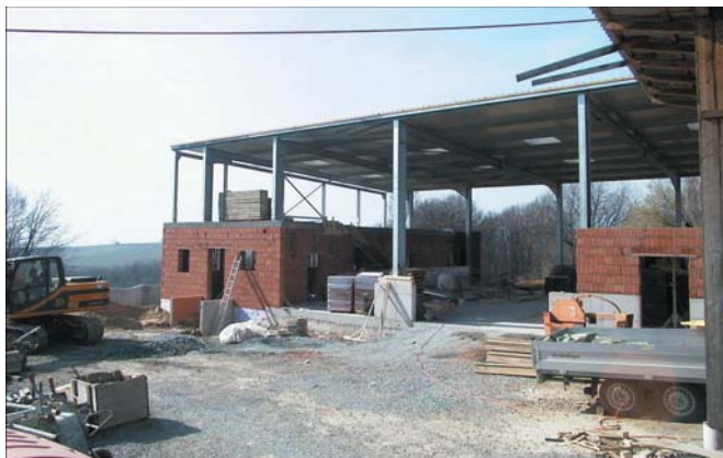
Die Bauarbeiten beim Bauhof in Stadtschlaining schreiten zügig voran. Der Werkstätten- sowie Sondermüllbereich wurden bereits erstellt. In den nächsten Wochen soll mit dem Innenausbau (Installation, Elektro, Fenster) begonnen werden.
