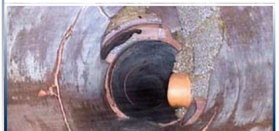
Ein kaputtes Kanalrohr in Stadtschlaining
